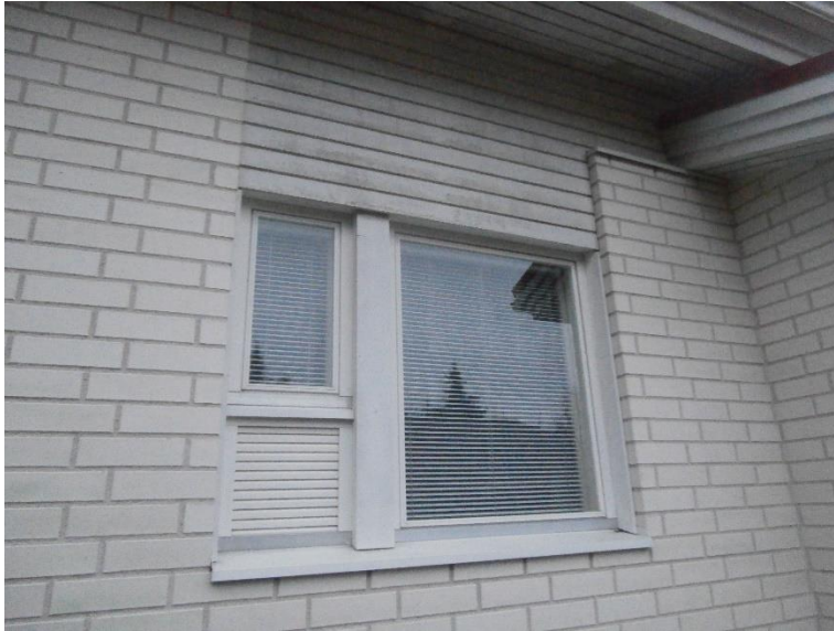
Kuva 8. Ikkunan yläpuolinen kulunut laudoitus.
