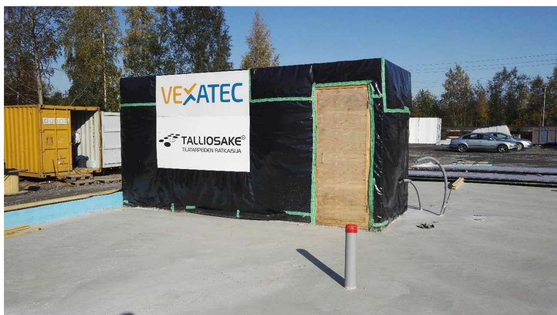
KUVA 5. Teknisen tilan elementti
