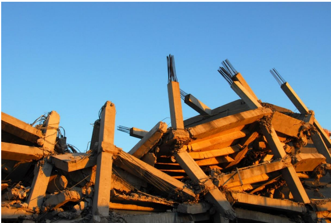
Kuva 1. Romahtaneet teräsbetonirakenteet. Kuvaaja Steve Hopson. [6]
