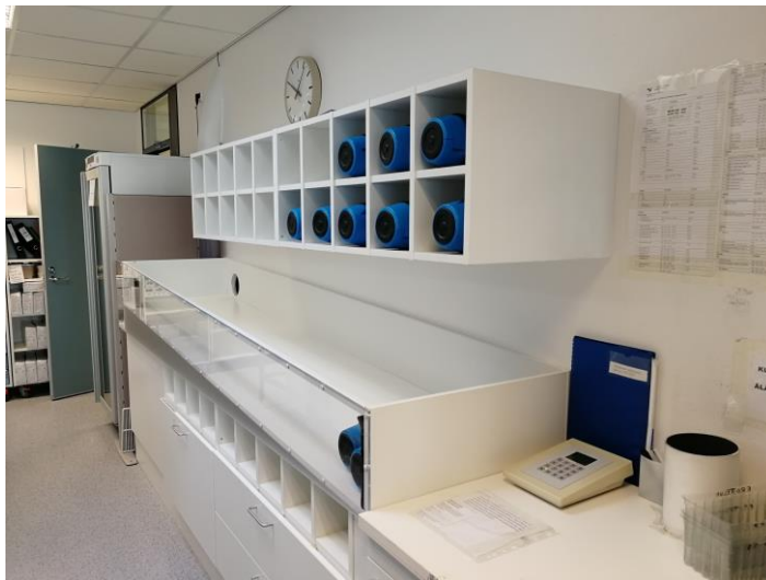
KUVA 2. Putkipostiasema klinisen kemian laboratoriossa (Kuva: Elina Hannuksela 2018)
