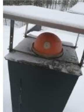
Takan piippu tulpattu vesikatolta
