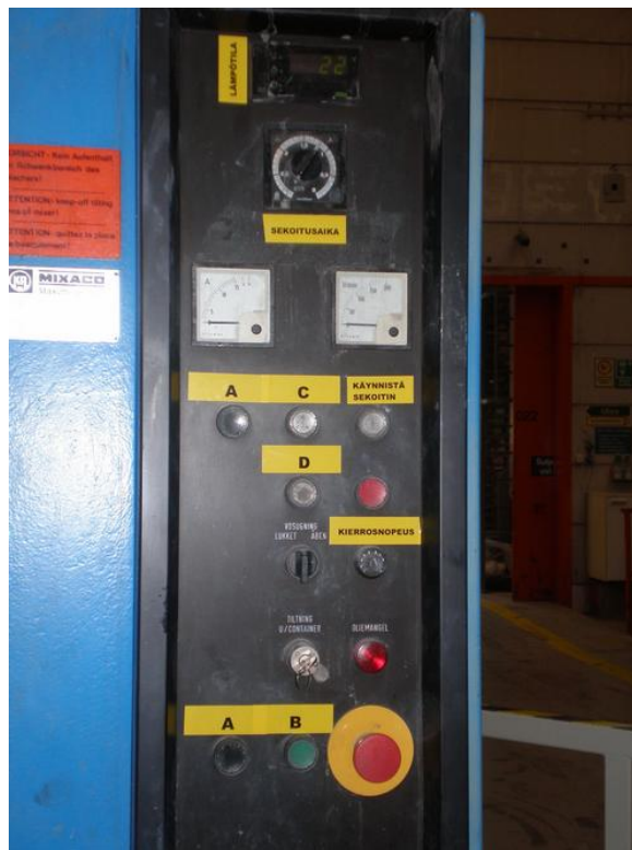
KUVA 4. Esisekoituslaitteen työohjeiden lisääminen käynnistystauluun.
