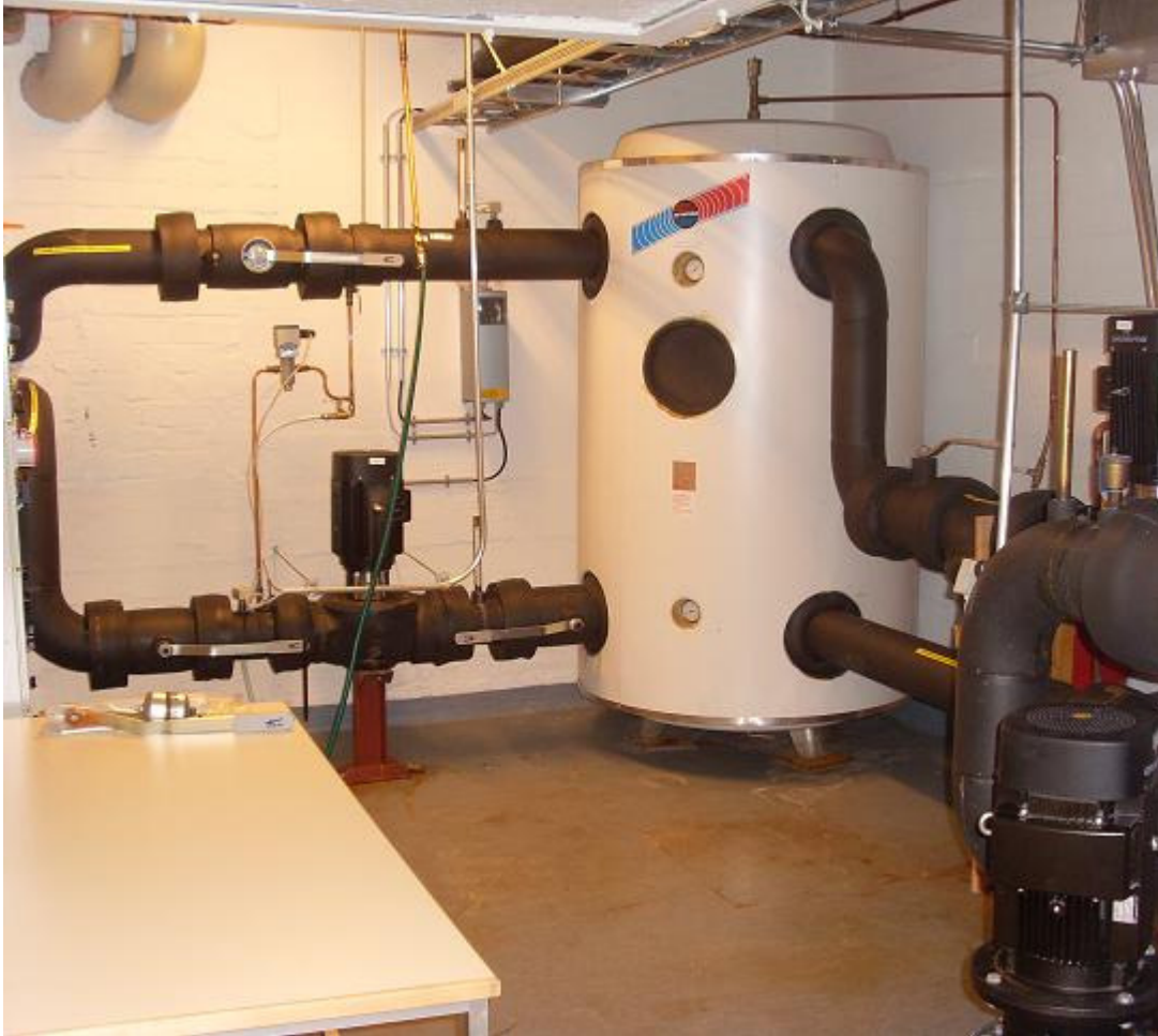
Sädesairaalan vedenjäähdytyskoneen VJK1 jäähdytysvesivaraaja ja jäähdytysvesiverkoston kiertopumppu P1.
