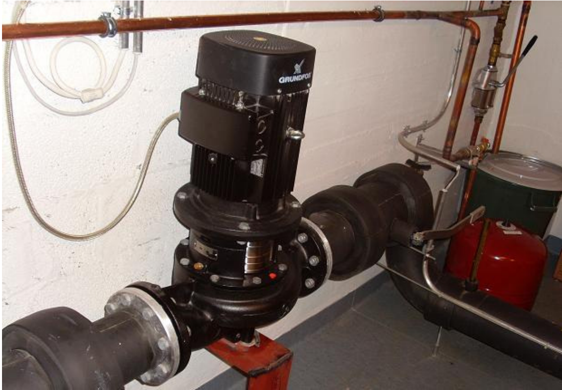
Sädesairaalan Vedenjäähdytyskoneen lauhdepiirin kiertopumppu P3.
