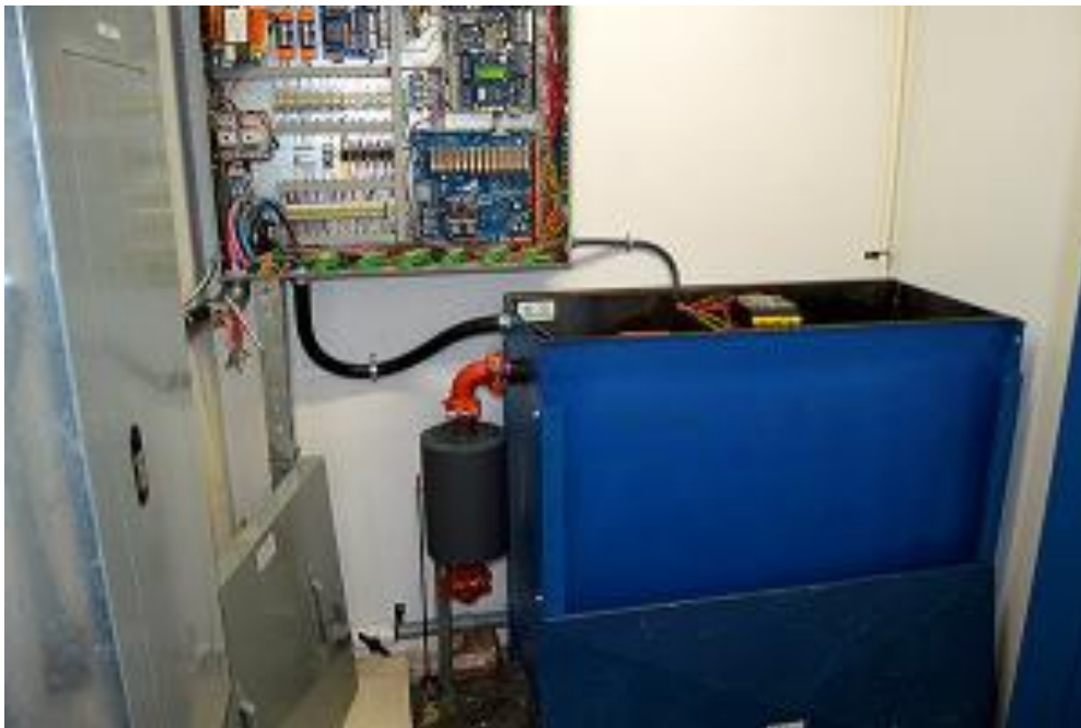
KUVA 13. Hydrauli hissien konehuone (The ABCs of Hydraulic Elevators 2017)
