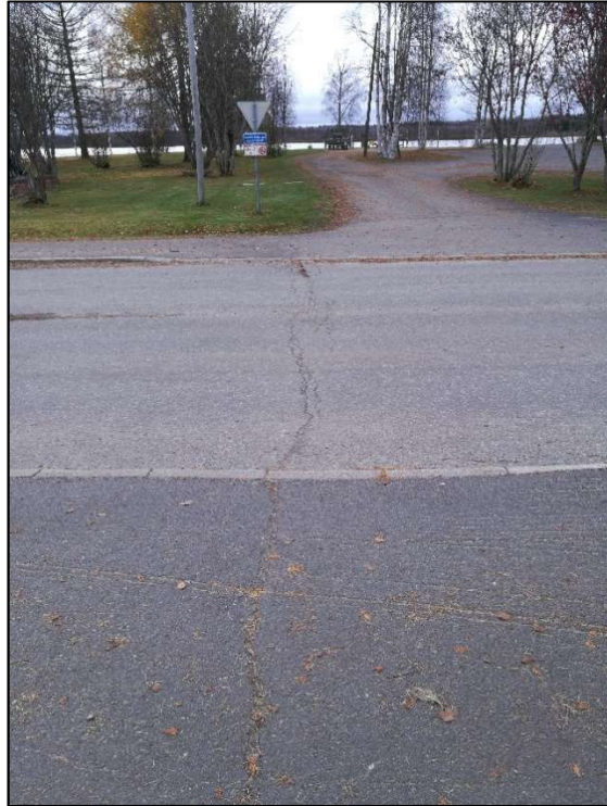
Kuvio 3. Kaukolämpöputken routimisen aiheuttamaa päällystevauriota Keskustien varrella
