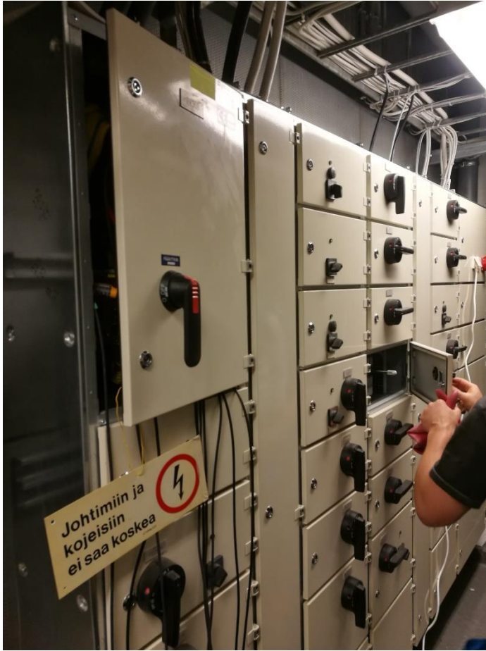
KUVA 6. Jakokeskus, jossa on käynnissä sähkönlaatumittaukset. (kuva: Matias Wiена)
