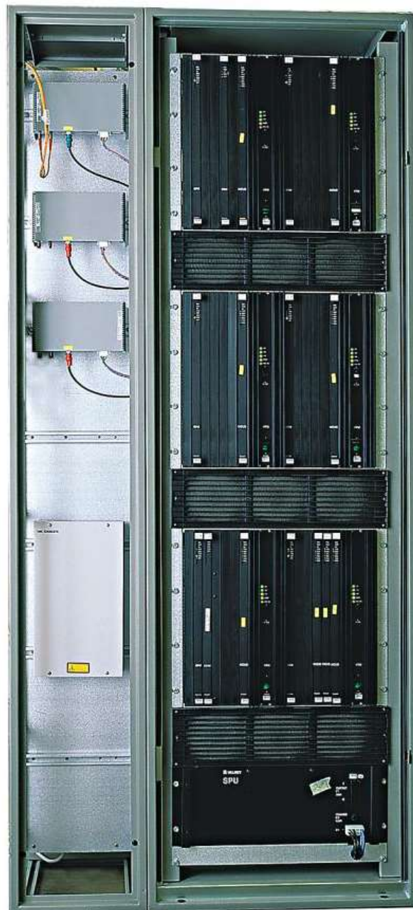
Kuva 4. VME-kaapin etupuoli. Kaapin vasemmalla on kaapelinousu ja oikealla laiteosa. (Valmet Oyj 2017j.)
