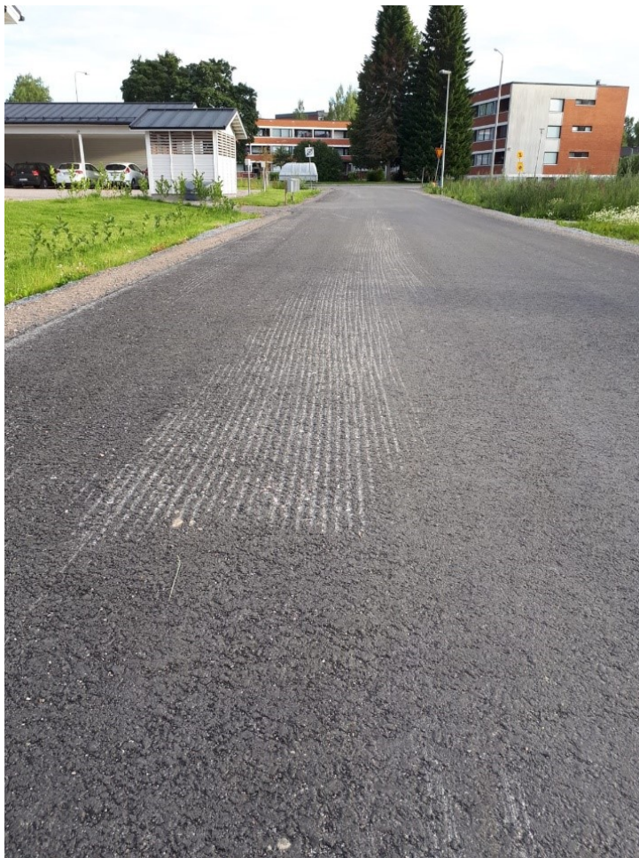
Kuva 8. Talvikunnossapidon aikana syntynyttä kulumaa.
