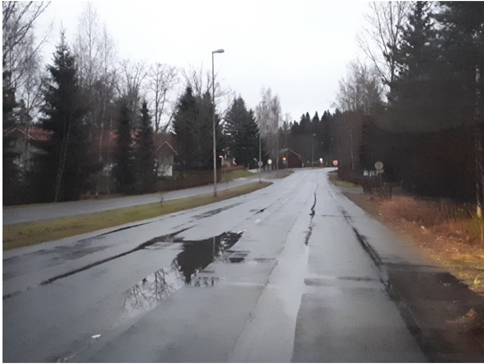
Kuva 7. Sadevesien kulkua padottava painuma.
