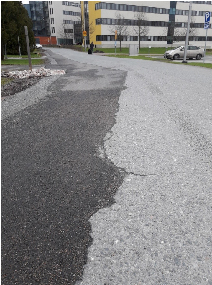
Kuva 10. Purkautumiseen altis asfalttipaikan sauma.
