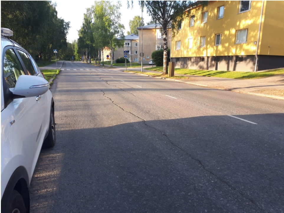
Kuva 5. Urautumista sekä pitkittäishalkeamaa ajourassa ja muualla päällysteessä.
