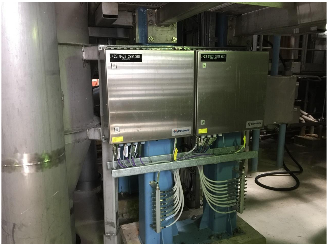
Kuva 3. Kaksi kenttäkoteloa ja niiden ilmajakotukit
