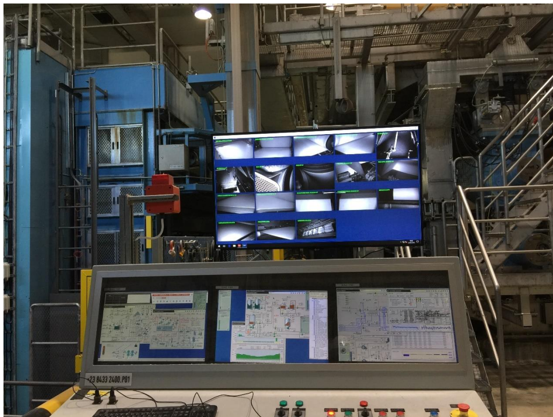
Kuva 10. Kenttänäyttö asennettuna märämpään ohjauspulpetin päälle
