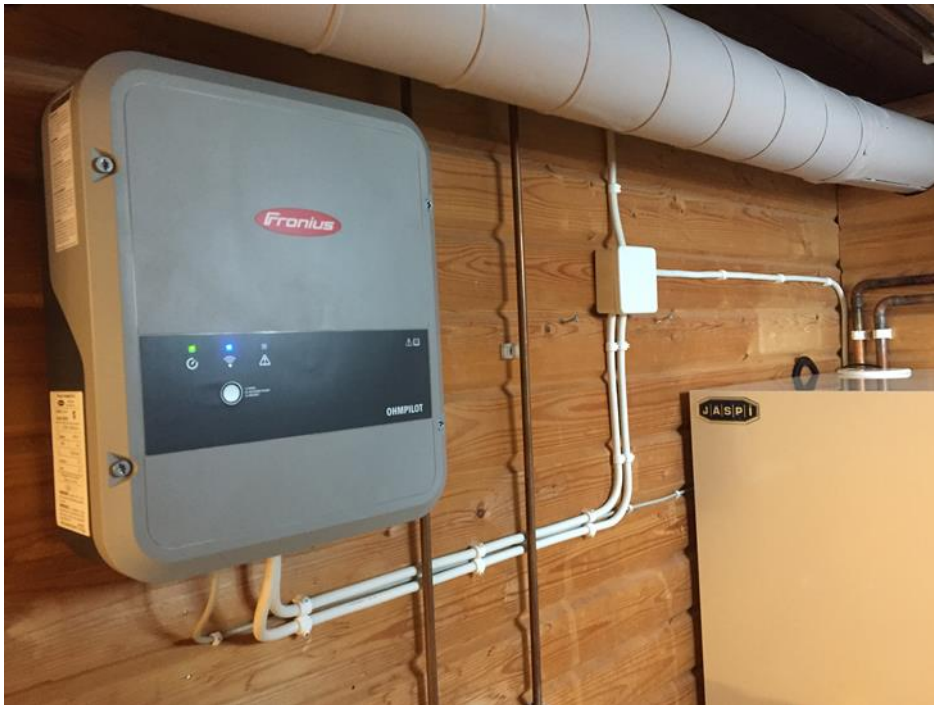
Kuva 22. Ohmpilot asennettuna. (Anna Kulo 2018)
