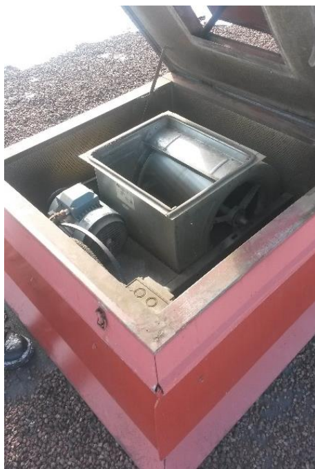
Kuva 20. Rakennuksen poistoilmapuhallin vesikatolla
