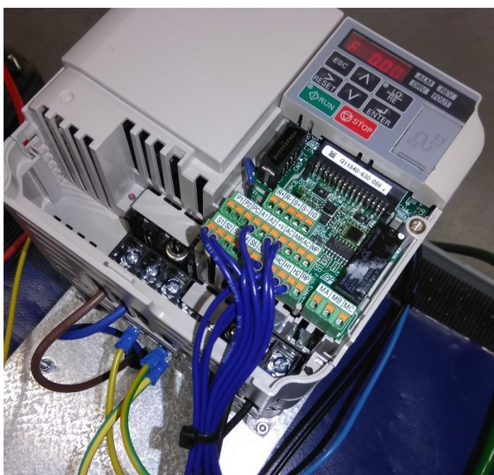
Kuva 13. Osittain johdotettu Omron V1000-taajuusmuuttaja.
