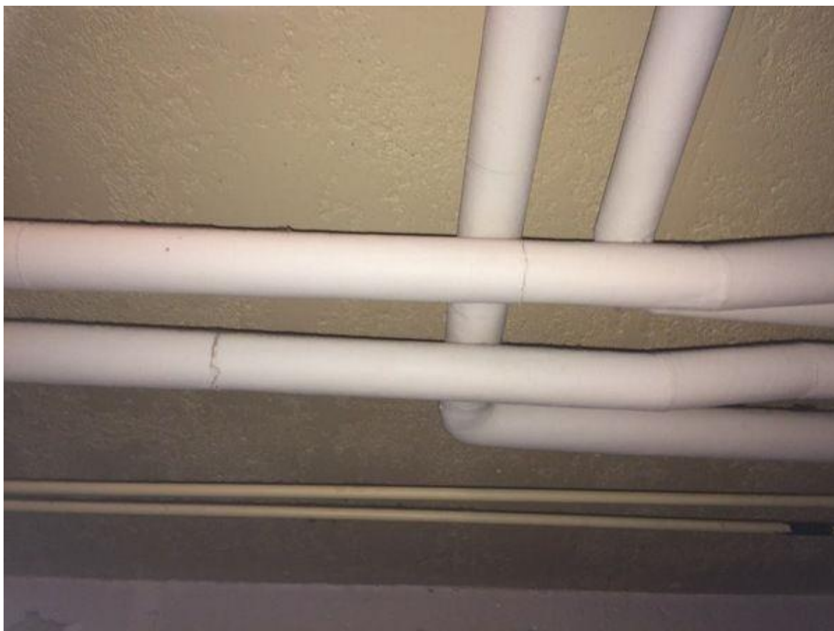
Bild 3 Bild på asbest som rörisolering från en annan byggnad (rakentaja.fi, 2018)
