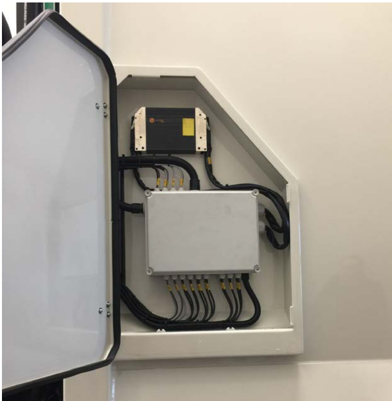
Kuva 29 PLC1 ja PLC2 sekä pakkaajan sähkökeskus, sama kuin Kuva 20
