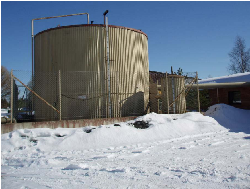
KUVA 13. Raskasöljysäiliö lämpökeskuksen takapihalla
