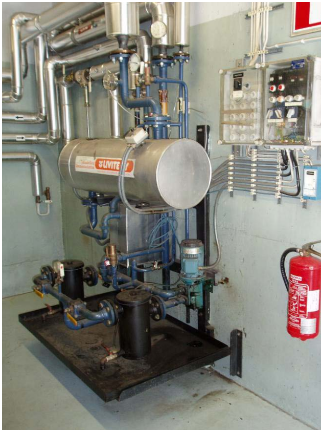
KUVA 14. Öljypumput ja öljynlämmitin. Kuvassa myös JK14.
