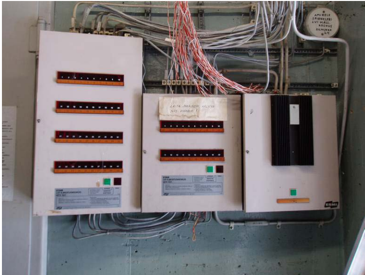
KUVA 8. Lämpökeskuksen kaksi Esmi LVI -ilmoituskeskusta ja teholähde
