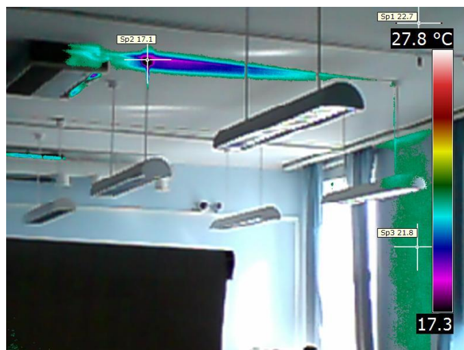
Kuva 43. Jäähdytyslaitteiden tarkistus ja suuntaus (yhdistelmäkuva) [30].
