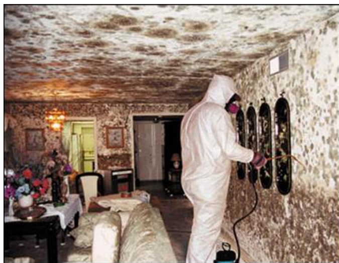
Kuva 24. Vakavasti homehtunut rakennus sisältä [23, s. 50].
