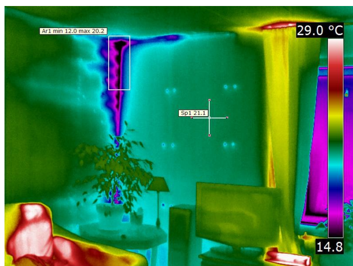
Kuva 22. PU-levyillä lisäeristetty rintamamiestalo, jossa on ilmavuotoa väliseinän kohdalla [30].
