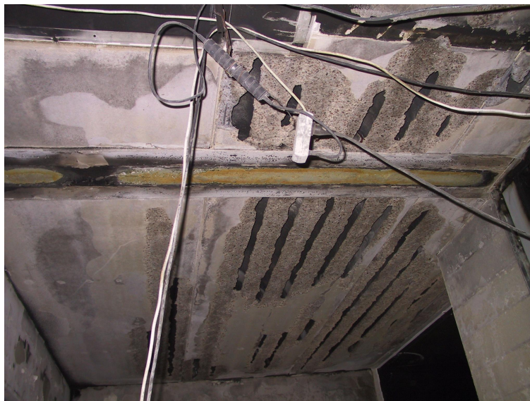
Kuva 48. Tulipalossa vaurioituneen ontelolaataston alapinta puhdistuksen jälkeen [29].
