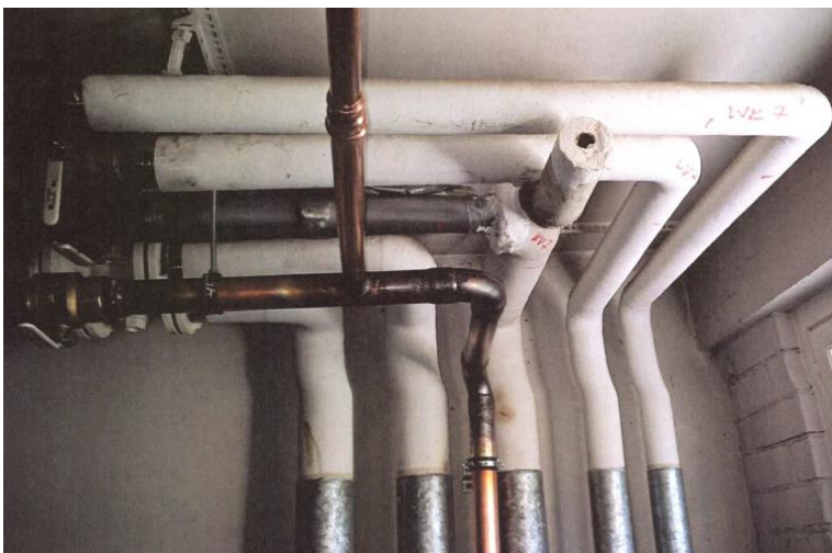
Kuva 6. Putkien asbestieristettä (RATEKO 2016)
