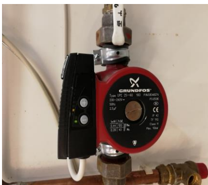
Kuva 10. Virtausmittauksissa käytetty kiertovesipumppu Grundfos UPE 25-60 180.
