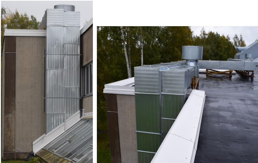
Kuva 16. IV-kone 316 TK/PK:n raitis- ja jäteilmakanaviston lävistysreitti kattoikkunan kautta ja nousu vesikatolle.
