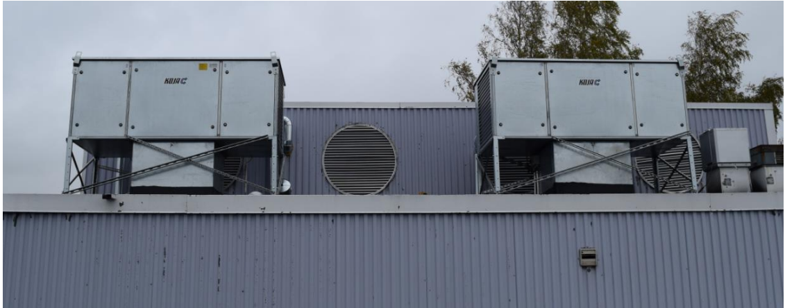
Kuva 10. IV-konehuoneen katto. Kuvassa vasemmalla 321PK ja oikealla 323PK.
