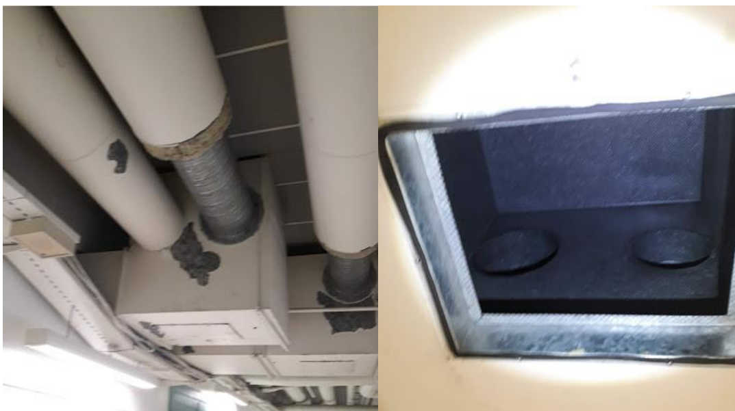
Kuva 14. Tuloilmakanavistossa ollut ilmanjakolaatikko, jonka sisällä äänieristeenä reikäpellillä päällystettyä villaa.
