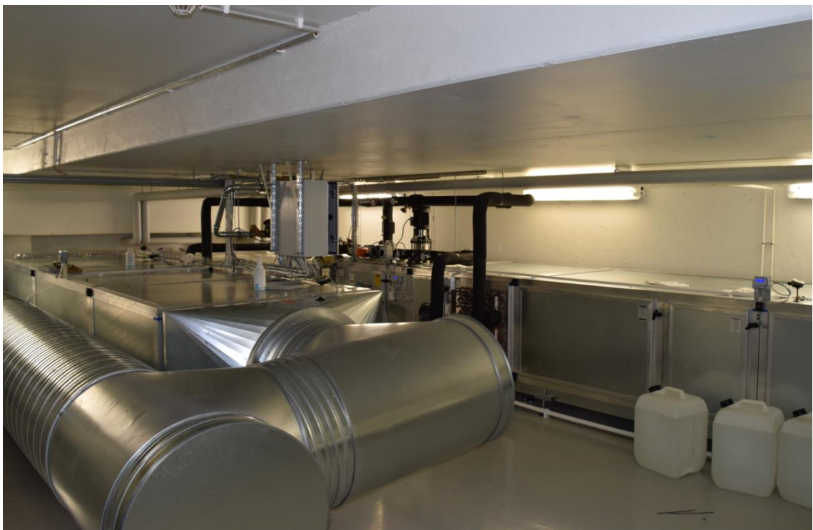
Kuva 8. 1. kerroksen IV-konehuone. Kuvassa vasemmalla 316TK ja oikealla 316PK.
