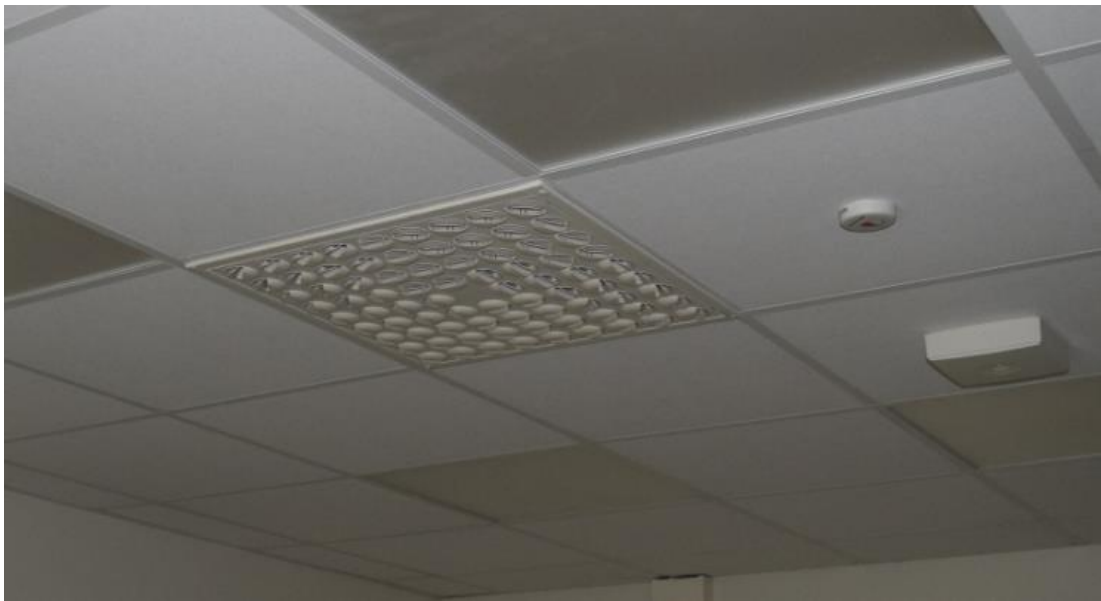
Kuva 3. Halton Oy:n valmistama TRI/S päätelaitte asennettuna 600mm x 600mm jakoiseen alakattorakenteeseen. Kuva otettu IV-kone 322TK/PK:n palvelualueella sijainneesta avoimesta oppimisympäristöstä.
