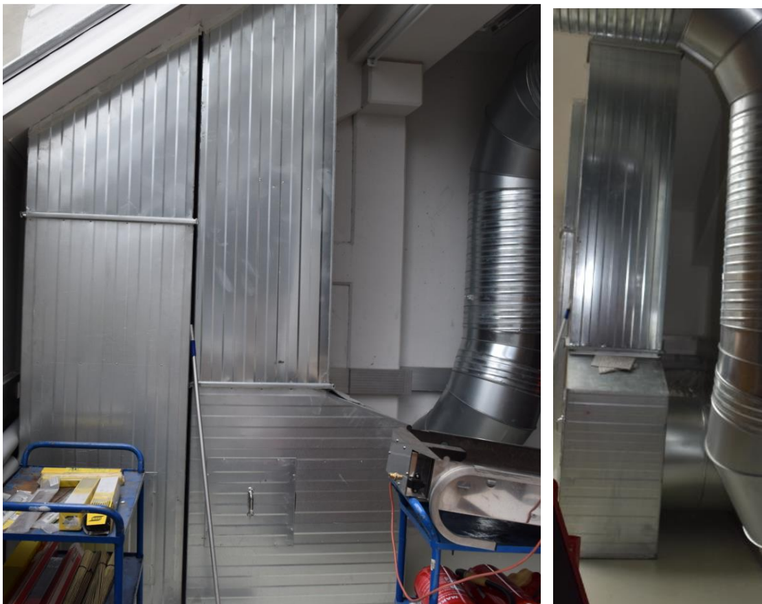
Kuva 15. IV-kone 316 TK/PK:n raitis- ja jäteilmakanaviston suorakaidekanavien ja pyöreiden kanavien liitososat 1. kerroksen teoria/demoluokassa.
