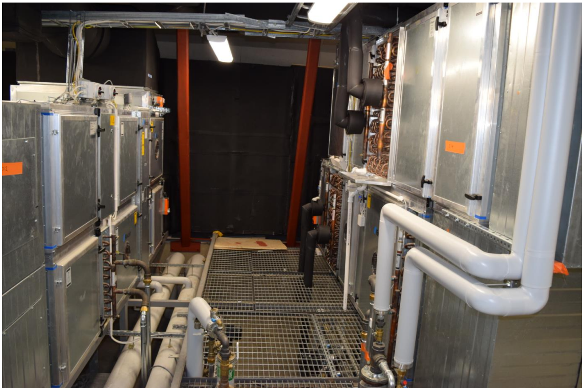
Kuva 6. IV-konehuone 1. Kuvassa vasemmalla 312 TK/PK ja oikealla 314 TK/PK. Takana näkyy kondenssieristetty tuloilmakammio.
