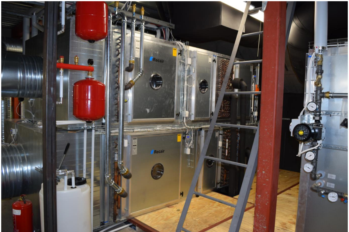
Kuva 7. IV-konehuone 2. Kuvassa päällä 321TK ja alla 323TK.
