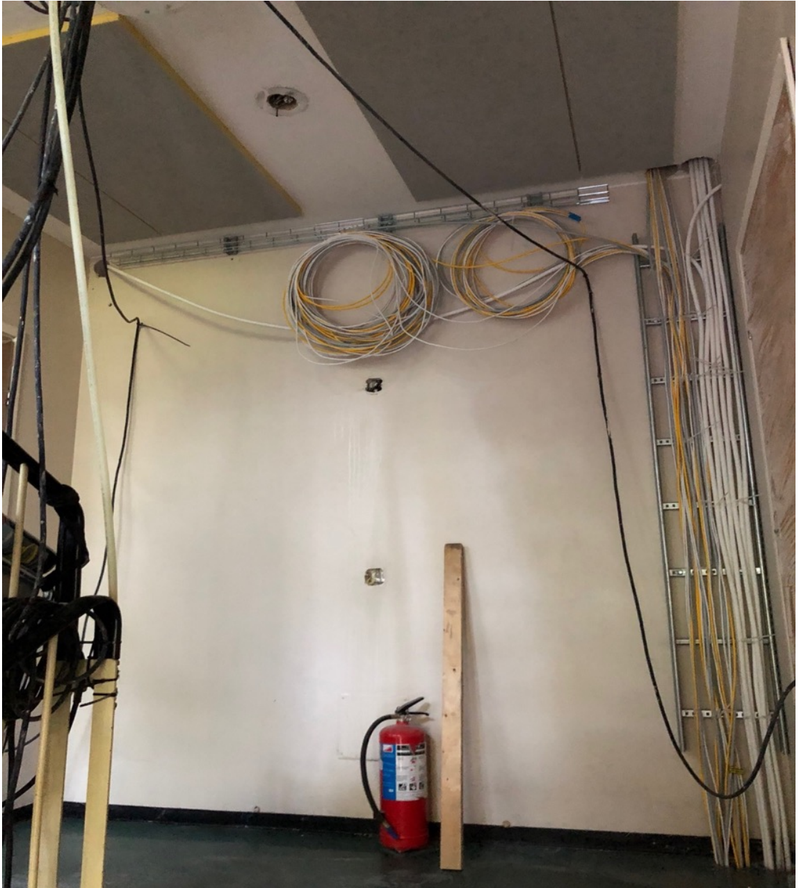
Kuva 5. Kuvassa porrastasoille asennetut sähkönousut.
