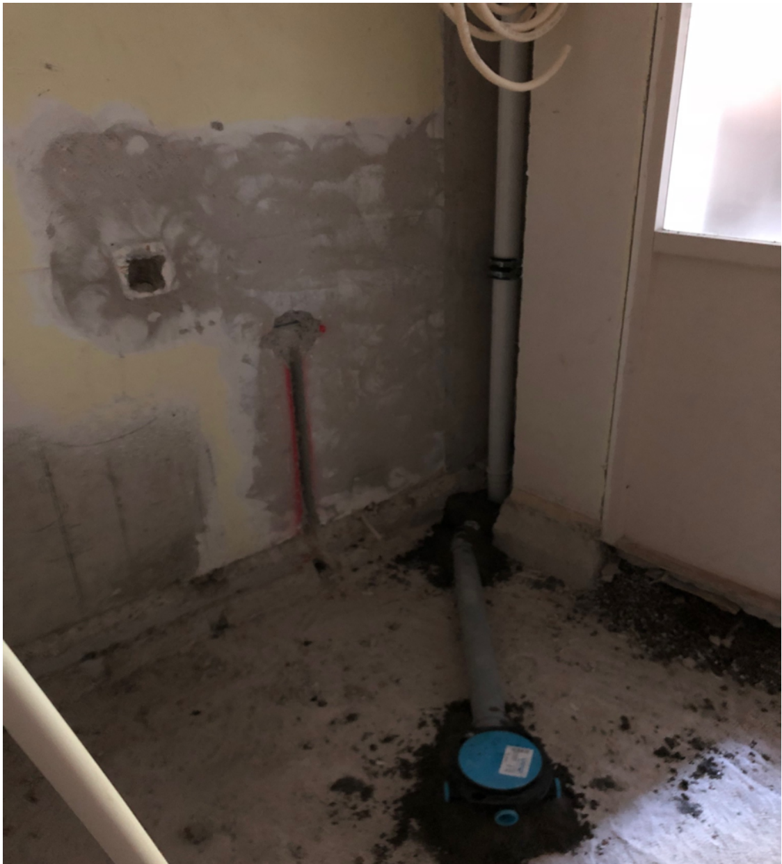
Kuva 4. Alimman kerroksen apukeittiön pystyviemäri ja lattiakaivo.
