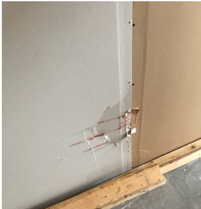
Kuva 5. Nostimen aiheuttama kolhu kipsiväliseinässä
