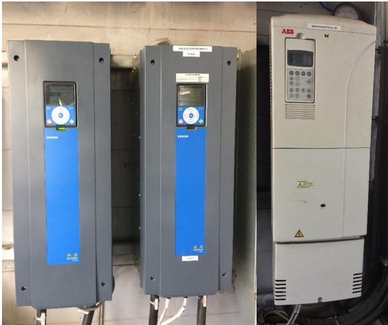
Kuva 10. Vasemmalla kaksi Vacon-taajuusmuuttajaa ja oikealla ABB-taajuusmuuttaja
