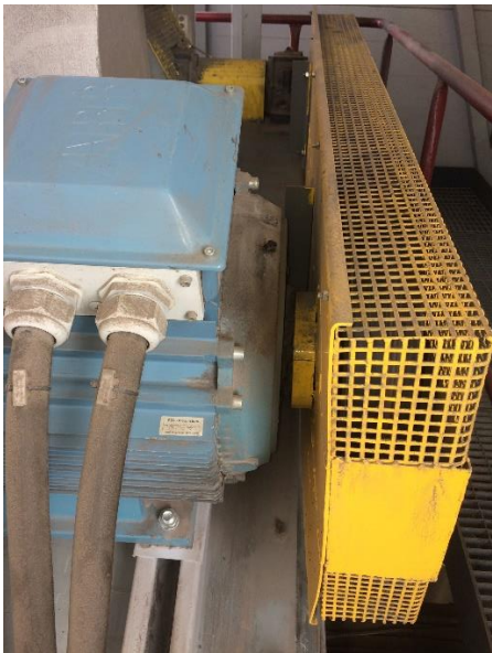
Kuva 12. Savukaasupuhaltimen moottori ja kiilahihna
