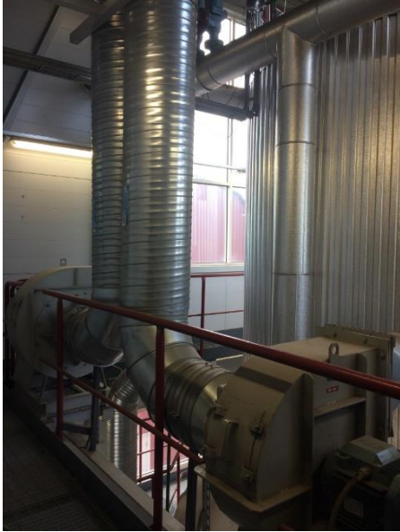
Kuva 11. Primääri- ja sekundääripuhaltimet
