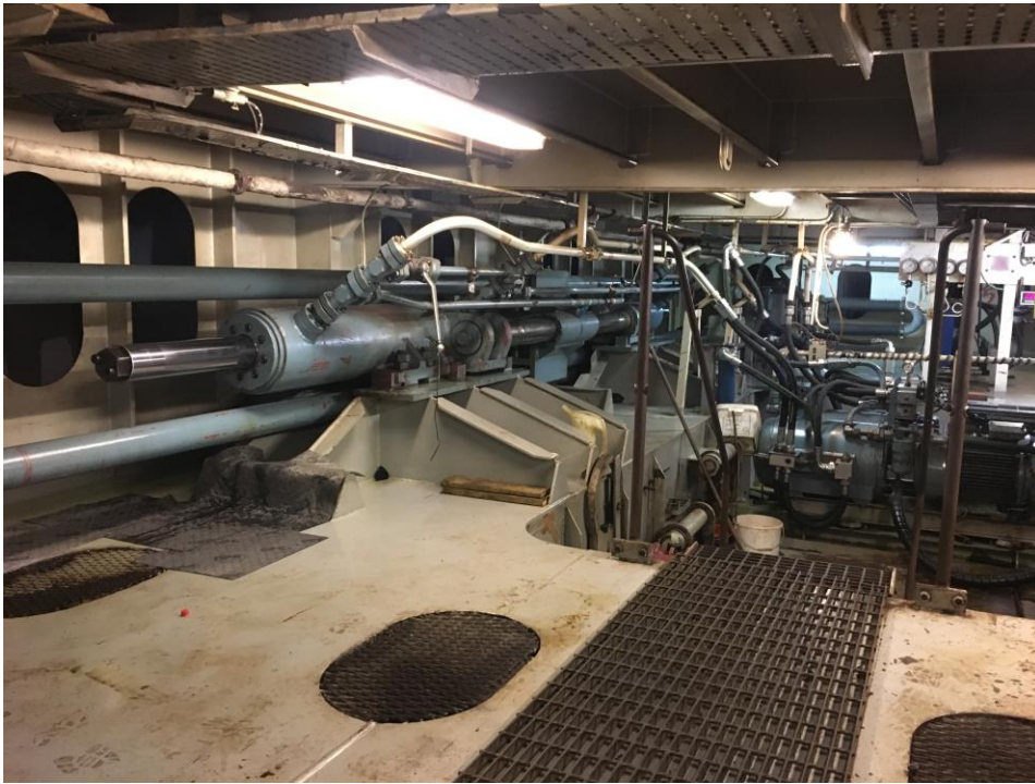
Kuva 9. M/s Wasa Expressin peräsinkonehuone. (Saviola 2018.)
