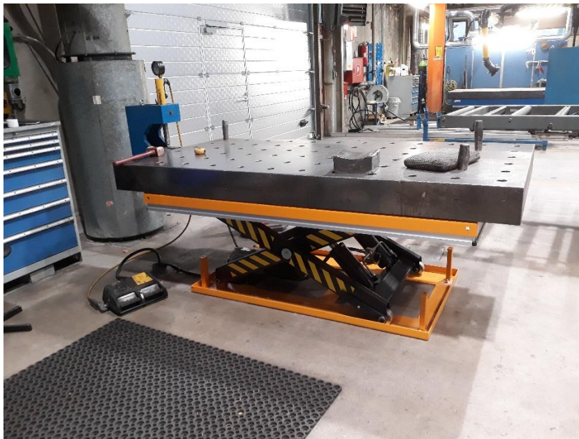
Kuva 18. Kohteeseen asennettu nostopöytä
