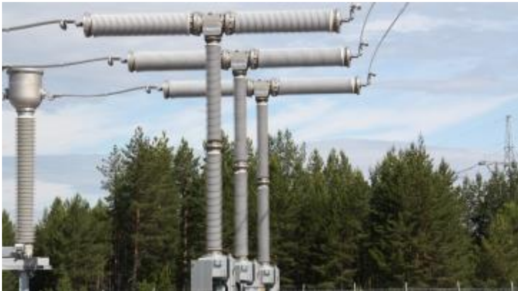
Kuvio 4 Erottavat katkaisijat ovat yleinen näky kantaverkon sähköasemilla. (Disconnecting circuit breakers. n.d)
