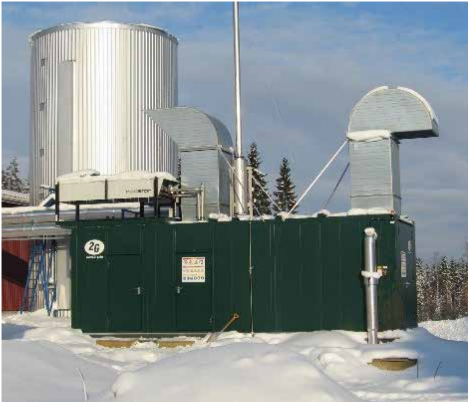
KUVA 2. Juvan Bioson Oy:n yhdistetty sähkön ja lämmöntuotantoyksikkö Juvalla Turakkan Puutarha Oy:n yhteydessä (kuva Hanne Soininen).
