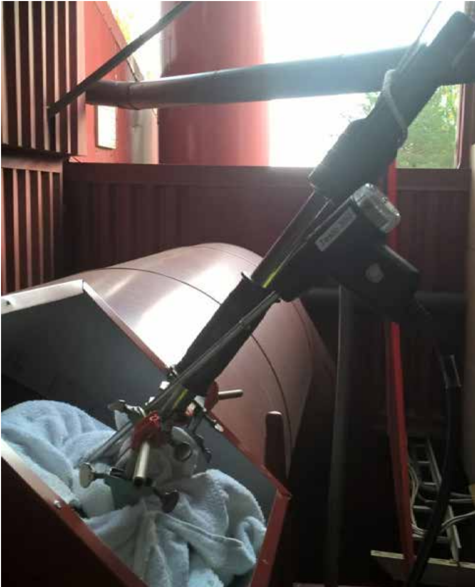
KUVA 2. Savukaasu- ja hiukkasmittaussondit savukaasukanavassa (kuva Riina Tuominen).
