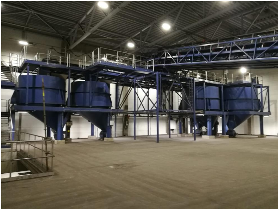
Kuva 2 Hienokiviaseman välisiilot (Kiuru 2018)
