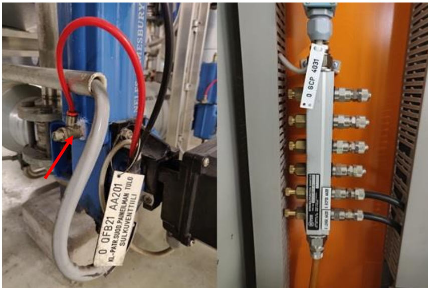
Kuva 24. Paineilmavuoto venttiileissä sekä paineilmatukeissa
