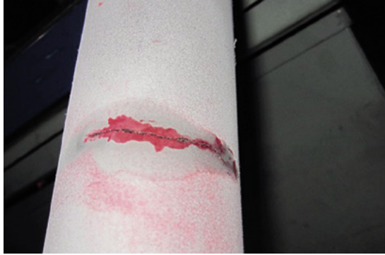
Kuva 29. Pitkä särö putkessa C.
