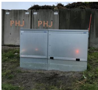
Kuva 11. Alueella sijaitseva katujakokaappi.
