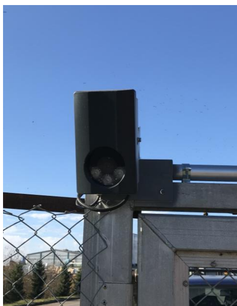
Kuva 18. Rekisterikilven luentalaite asennettuna jätekeskuksen portille.
