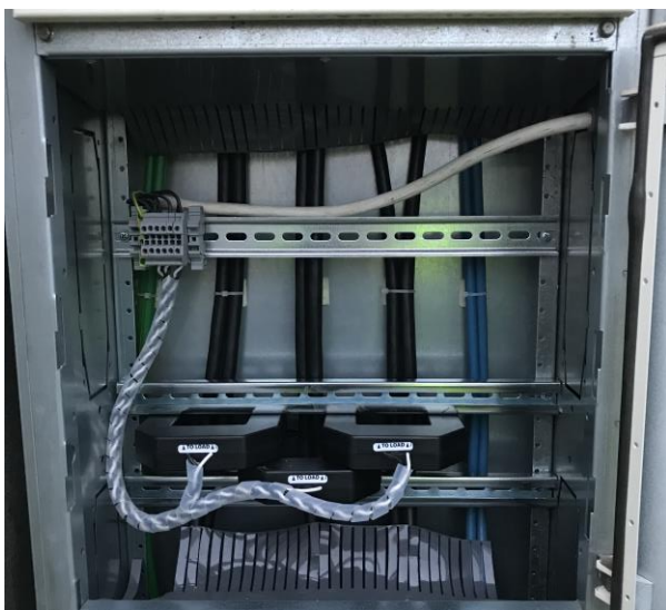
Kuva 17. Avattavia virtamuuntajia tuettuna asennuskiskoilla.
