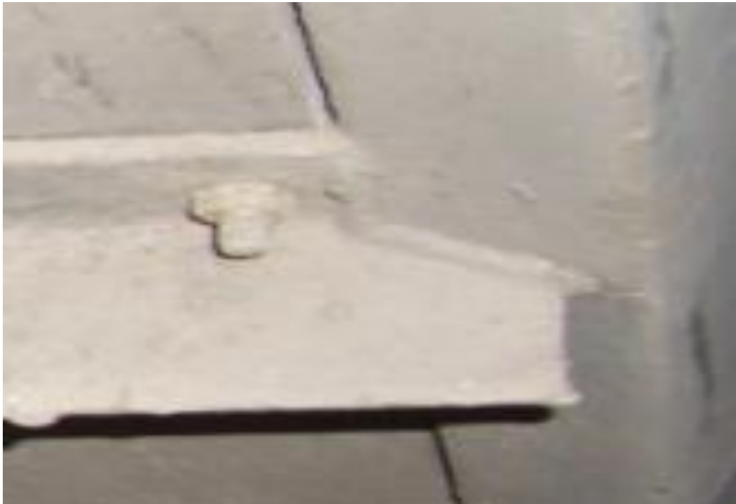
Kuva 10. Poikittaistukena käytettiin kulmarautaa ennen muutosta
