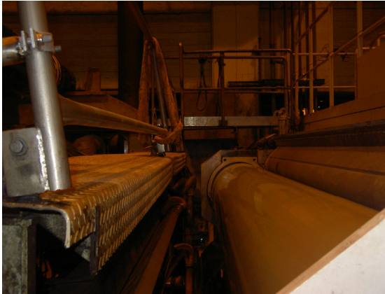
Kuva 22. Soft-telan päällä työskentelyn tippumisvaara
