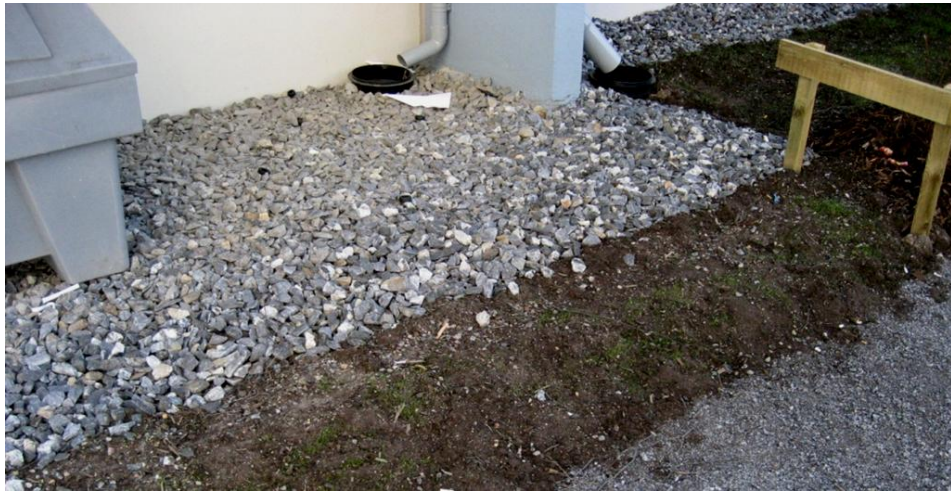
Kuva 21 Kivituhkan ja sepelin välissä ei tarvittaisi nurmikkoa lainkaan.
