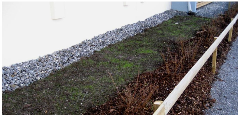
Kuva 20 Vaikeasti hoidettava ja turha nurmikko seinän ja kulkuväylän välissä. Ruusujen kasvaessa nurmikko jää miltei kokonaan varjoon ja sammaloituu nopeasti.
