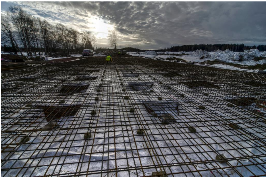
Kuva 4. Länsikyläntien sillan (127) paalulaatta ja rauditus, niin sanottu sienilaatta [9.]. Tien leveydestä johtuen paalut ovat viidessä rivissä poikkisuunnassa.
