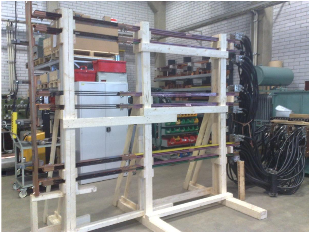
Kuva 3 Mittauksia varten rakennettu virtakiskosto. Yksi vaihe koostui kahdesta osakiskostosta. Osakiskojen välinen etäisyys on 150 mm ja vaiheiden välinen etäisyys osakiskojen keskivälistä mitattuna 800 mm.
