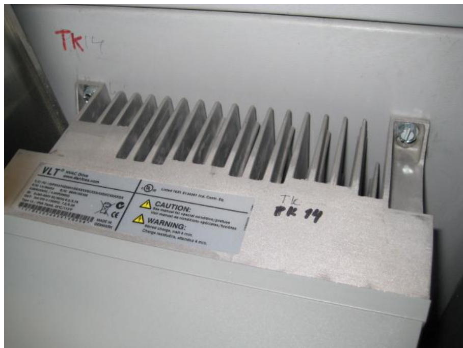
KUVIO 8 Taajuusmuuttaja väärinasennettuna: ei ilmarakoa
