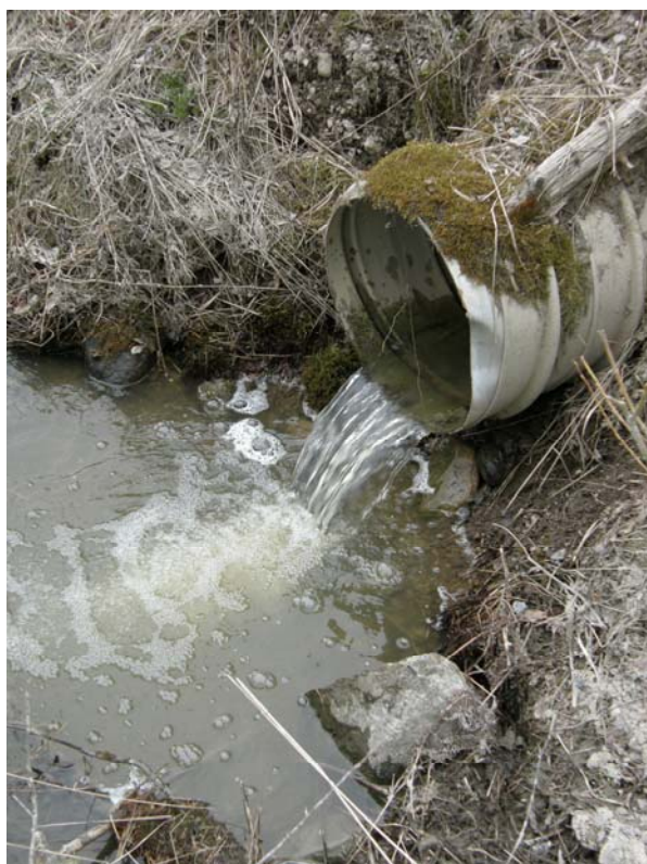
Kuva 5: Liian korkealle sijoitetut tierummut estävät kalojen etenemisen puroissa ja muodostavat näin vaellusesteitä. (Salla Vuorma, 2010.)
