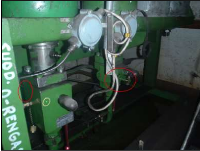
Kuva 4. Korkeapainejärjestelmän paineenpurku ja paineenalennusventtiilien käsihanat.
