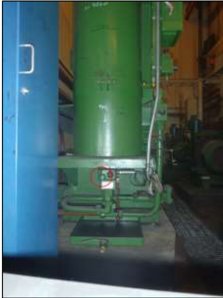
Kuva 6. Matalapainejärjestelmän paineenpurku - paineenalennusventtiilin käsihana.
