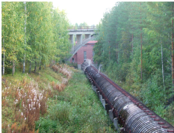
KUVIO 7. Säännöstelypadolta voimalaitokselle johtava putki on jättänyt vanhan koskiuoman kuiville. Kuva: Juha Piilola.
