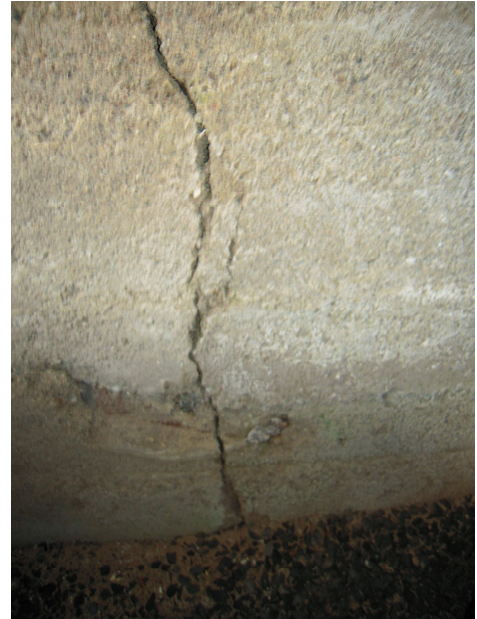
Kuva 1: vanhan puolen sokkelin halkeama
