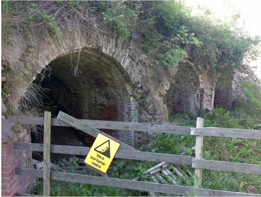
Kuva 11. Kunnostamattomia poterneja Kotkan Kyminlinnassa
