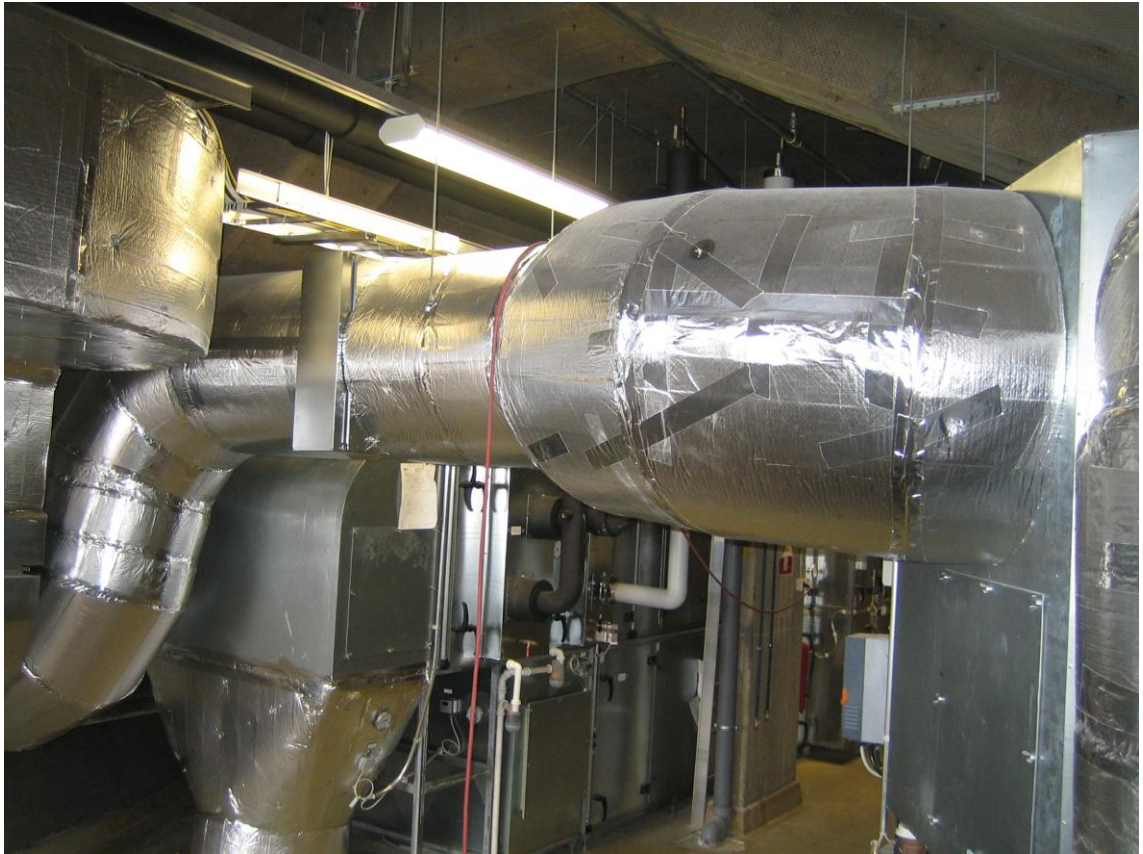
Kuva 16. Ilmanvaihtokoneen 392 TK/PK jäteilmakammio.
