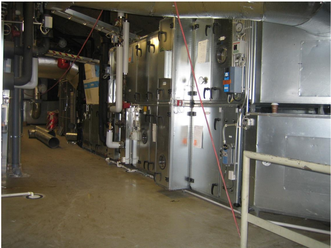
Kuva 13. Ilmanvaihtokone 392 TK/PK kanavistoineen.
