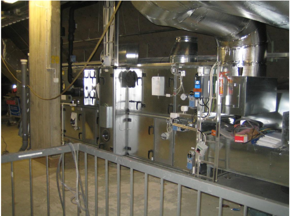
Kuva 14. Ilmanvaihtokone 394 TK/PK kanavistoineen.
