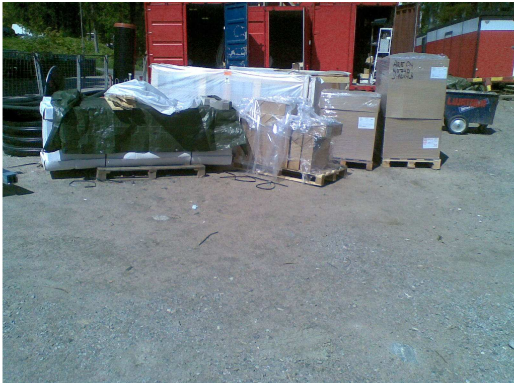
Kuvio 7. Ulos varastoidut rakennusmateriaalit ovat irti maasta ja ne on suojattu muoveilla sateelta.
