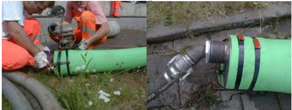
Kuva 24: Muotoputkisujutuksen viimeistelyä. Sujutetun muotoputken päähän asennetaan erityinen kaulus, joka mahdollistaa paineellisen höyryn syöttämisen putkeen. [26.]
