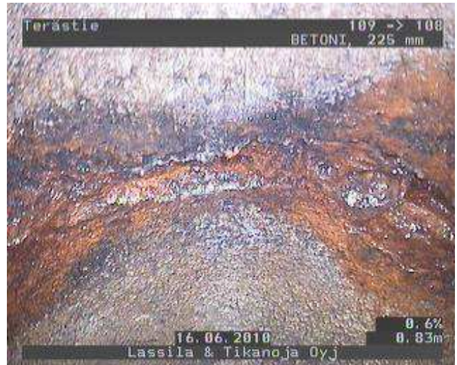
Kuva 50: Vuoto viemäriputkien liitoksessa.
