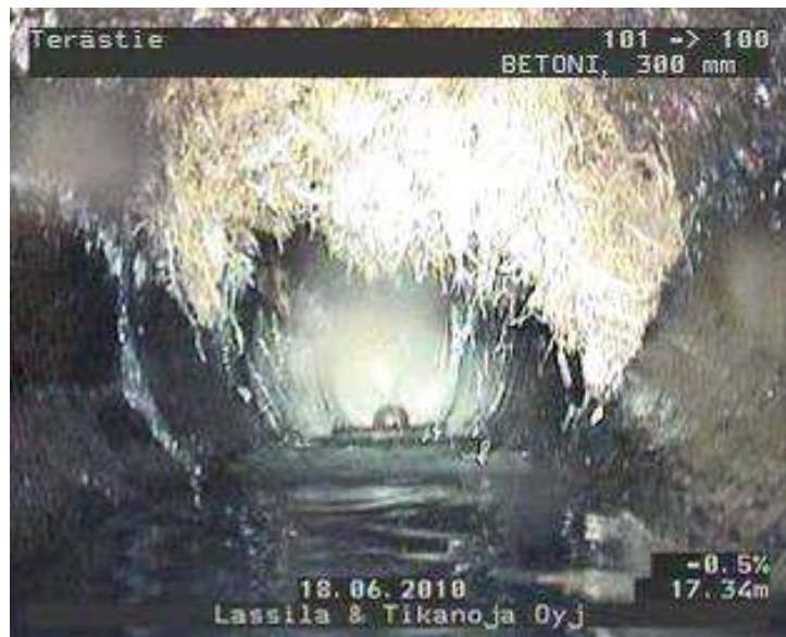
Kuva 52: Putken painumaa kaivoväliltä 102 - 101.
