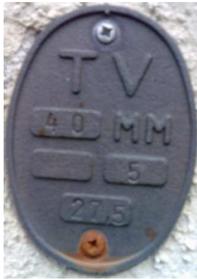
Kuva 48: Kiinteistön Terästie 12 tonttiventtiilin merkkikilpi.
