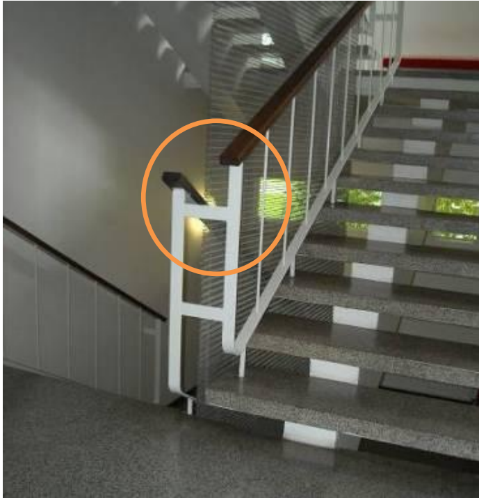
KUVA 18. Käsijohte loppuu portaiden jälkeen eikä se ohjaa portaissa kulkevaa seuraavalle käsijohteelle
