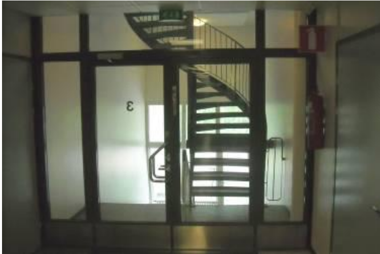
KUVA 27. P-osan 3. Kerroksen päässä olevasta ovesta puuttuu tarranauha
