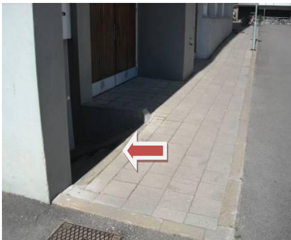
KUVA 7. Huonosti hahmotettavat alas johtavat portaat aiheuttavat putoamisvaaran
