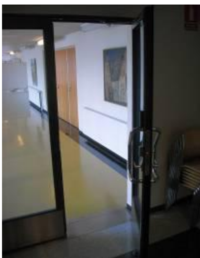
KUVA 32. S-osan käytävän ensimmäinen palo-ovi
