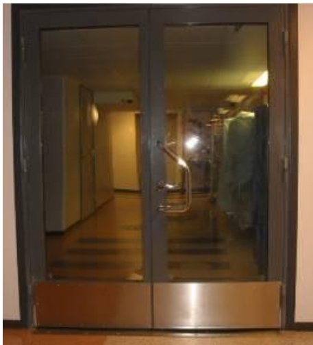
KUVA 29. P-osan kellarikerroksen palo-ovi
