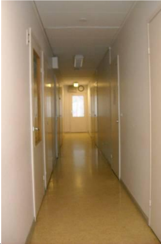
KUVA 17. S-osan 6. kerroksen ryhmätyötilojen käytävän valaistusvoimakkuus on 12 luksia (viitearvona pidetään 300 luksia)
