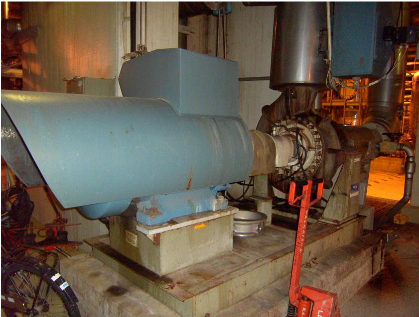
Kuva 4. Pumpun suojaus tuotantolinjalla.
